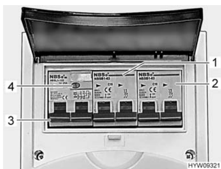
Fig. 139 Interruttore di sicurezza e interruttore automatico FI (scatola dei fusibili a 230 V)
