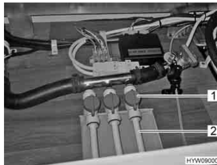
Fig. 155 Valvole di mandata del riscaldamento a pavimento
