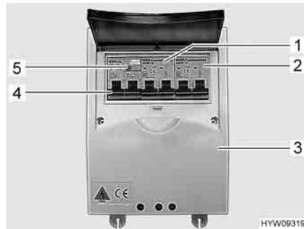
Fig. 128 Interruttore di sicurezza e interruttore automatico FI (scatola dei fusibili a 230 V)
