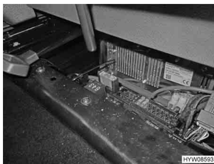
Fig. 49 Relè e portafusibili
