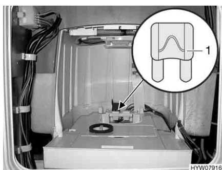
Fig. 46 Fusibile della toilette Thetford
