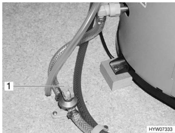
Fig. 87 Rubinetto di scarico del boiler
