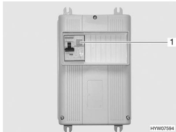
Bild 109 230-V-Sicherungskasten mit Leitungsschutzschalter und FI-Schalter
