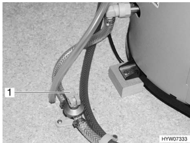
Fig. 83 Rubinetto di scarico del boiler
