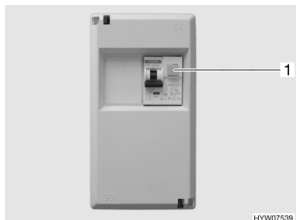
Bild 69 230-V-Sicherungskasten mit Leitungsschutzschalter und FI-Schalter
