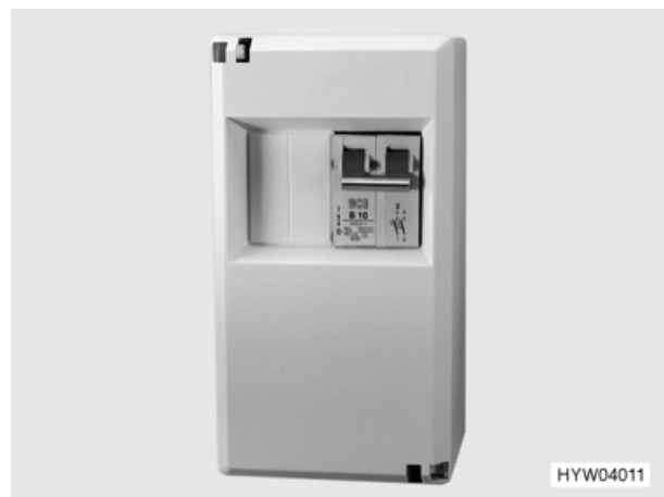
Bild 68 230-V-Sicherungskasten mit Leitungsschutzschalter
